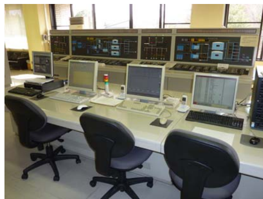
▲ 玉里新配水場 中央監視操作室
